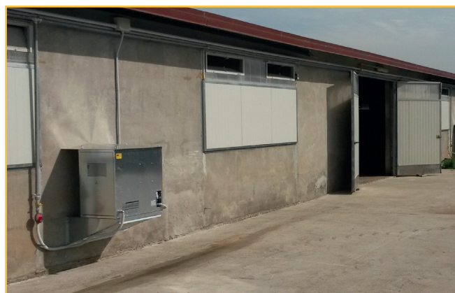
INSTALACJA NA ZEWNĄTRZ
